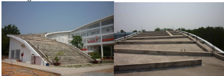
Hình 1: Hiện trạng mái trường
